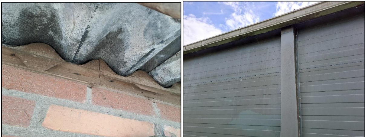
Foto links: delen van het metselwerk sluiten nauw aan op de betimmering en golfplaten waardoor de gevel niet toegankelijk is voor vleermuizen om een verblijfplaats te bezetten. Foto rechts: sandwichpanelen die nauw aansluiten op elkaar en delen van het dak waardoor de gevel niet toegankelijk is voor vleermuizen om een verblijfplaats te bezetten.
