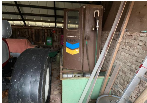
Figuur 17: Bovengrondse dieseltank met pomp
